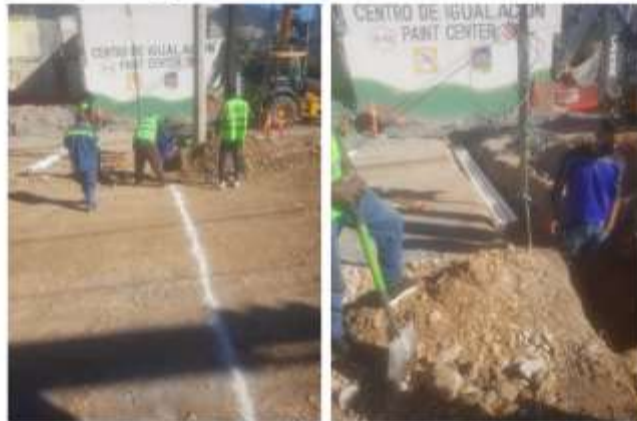
INSTALACIÓN DE MANGAS PARA CRUCE DE TUBERÍA EN CALLE HIDALGO LADO ORIENTE
