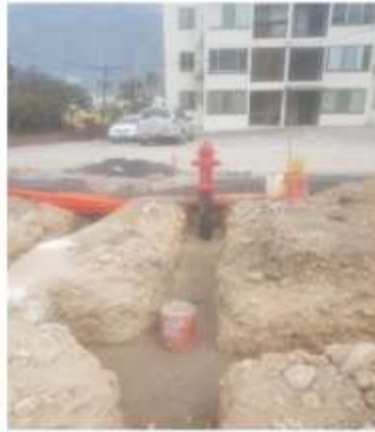
HIDRANTE EN CALLE ALLENDE
