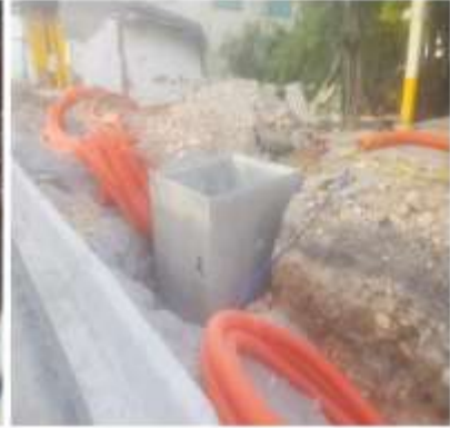
REGISTRO DE MEDIA TENSIÓN ENTRE CORREGIDORA E HIDALGO
