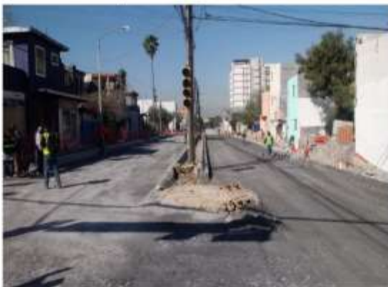
VISTA GENERAL DE CUERPOS NORTE Y SUR EN BASE TERMINADA Y GUARNICIONES ENTRE ALLENDE Y ABASOLO
